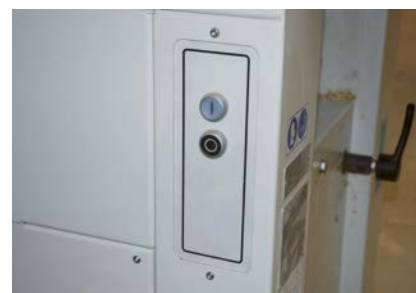
Commande électrique au poste de rabotage avec renvoi au poste de mortaisage.
