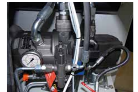
Unidade de controlo hidráulica
