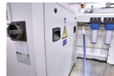
Quadro elétrico integrado na base do tanque para reduzir o espaço no chão.
