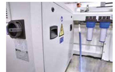
Um den Platzbedarf zu reduzieren, wurde die Schalttafel im Untergestell des Behälters integriert.
