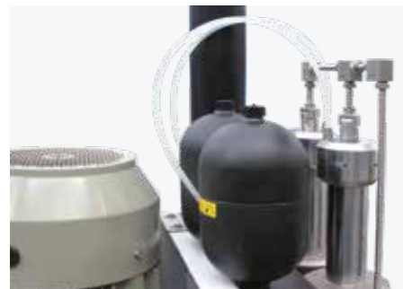
Accumulateur d'azote pour la gestion du circuit de retour des vérins hydrauliques
