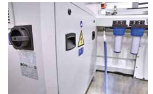
Quadro elettrico integrato al basamento della vasca per ridurre l'ingombro a terra.
